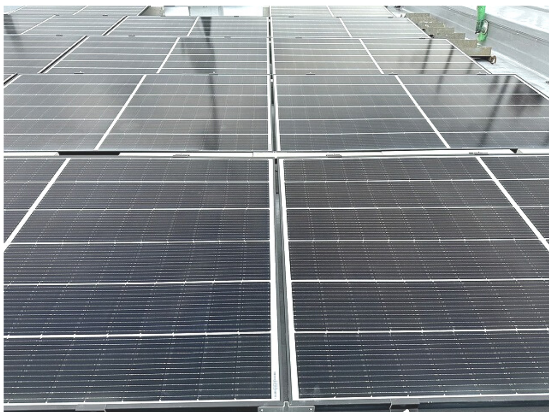
太陽光パネル
